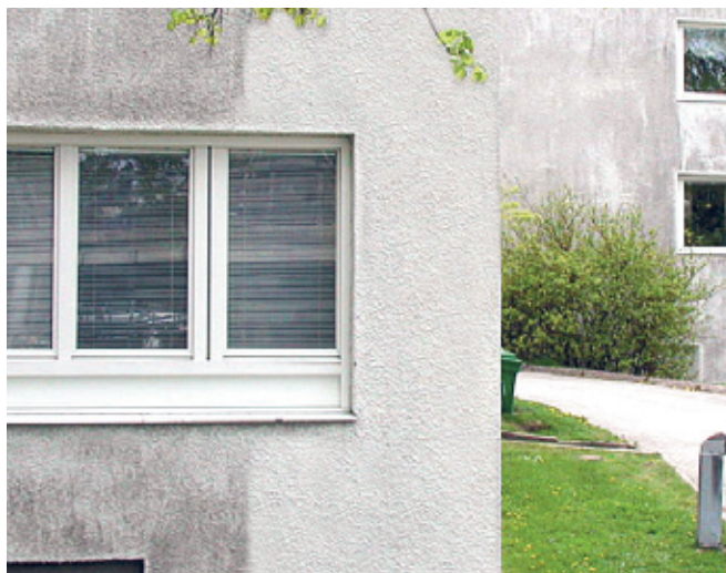
Fasad med påväxt av mögel och alger, ett år efter behandling av ett avgränsat parti.
